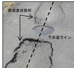
図-1 路面変状発生状況
