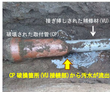
図-6 破壊された取付管(地点 C)
