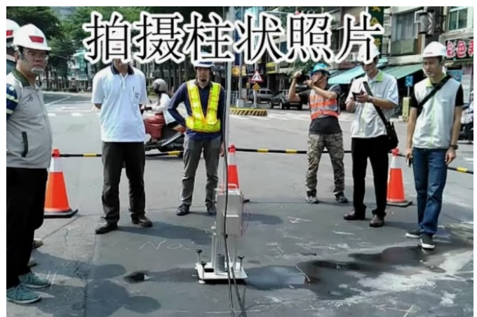
空洞発見箇所での詳細調査
