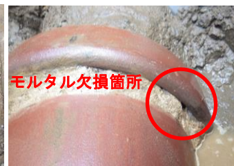
図-11 継手欠損箇所
